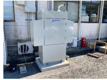
▲⑫町無線用発電機
