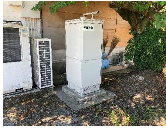
▲⑪県無線用発電機
