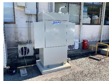
▲⑱町無線用発電機
