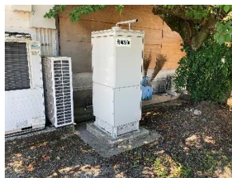
▲⑰県無線用発電機
