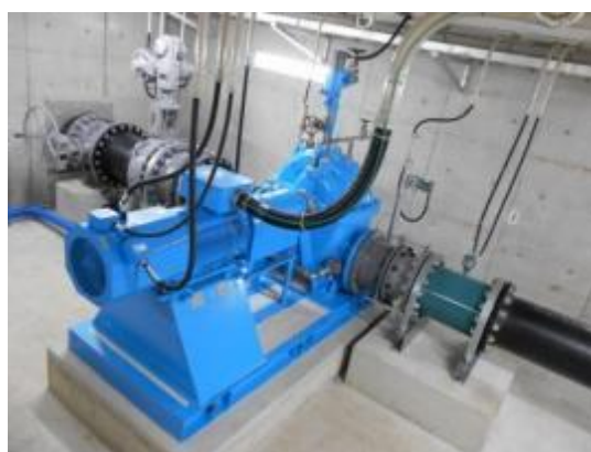
小水力発電（戸島送水場）
