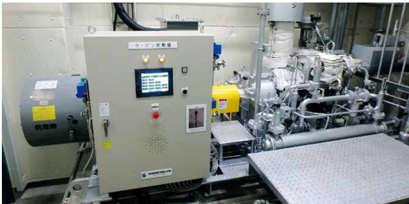
▶ 蒸気タービン・発電機
