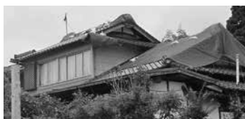
屋根の被災状況
