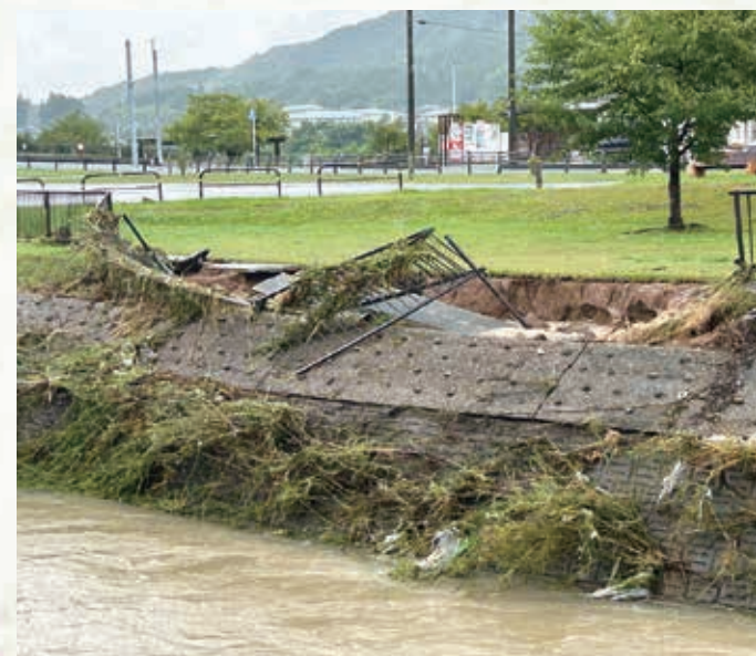
木葉川右岸損壊状況
