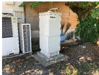
▲⑰県無線用発電機
