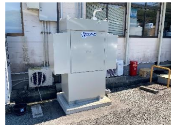
▲⑱町無線用発電機
